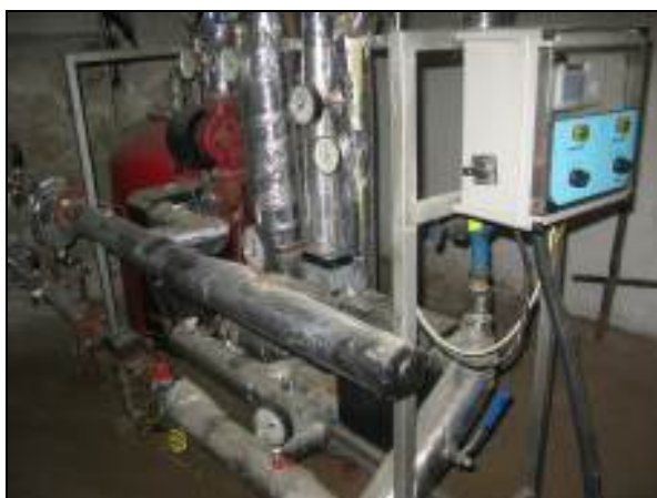
Фиг.1.18 Абонатна станция вход «Б»
